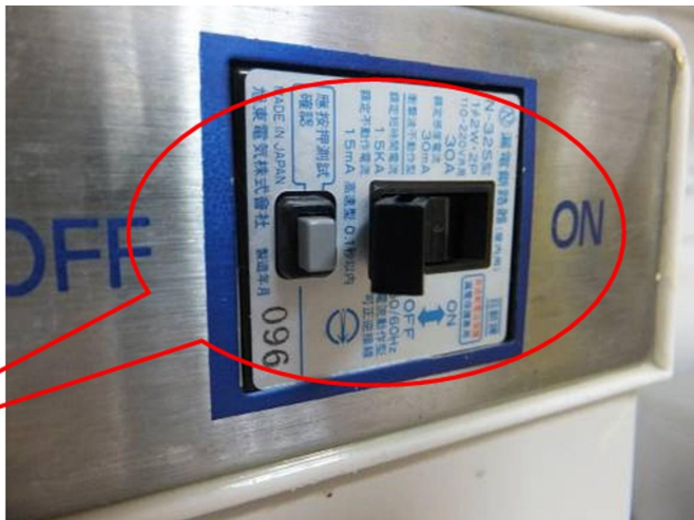
茶水間蒸飯機 漏電斷路器
