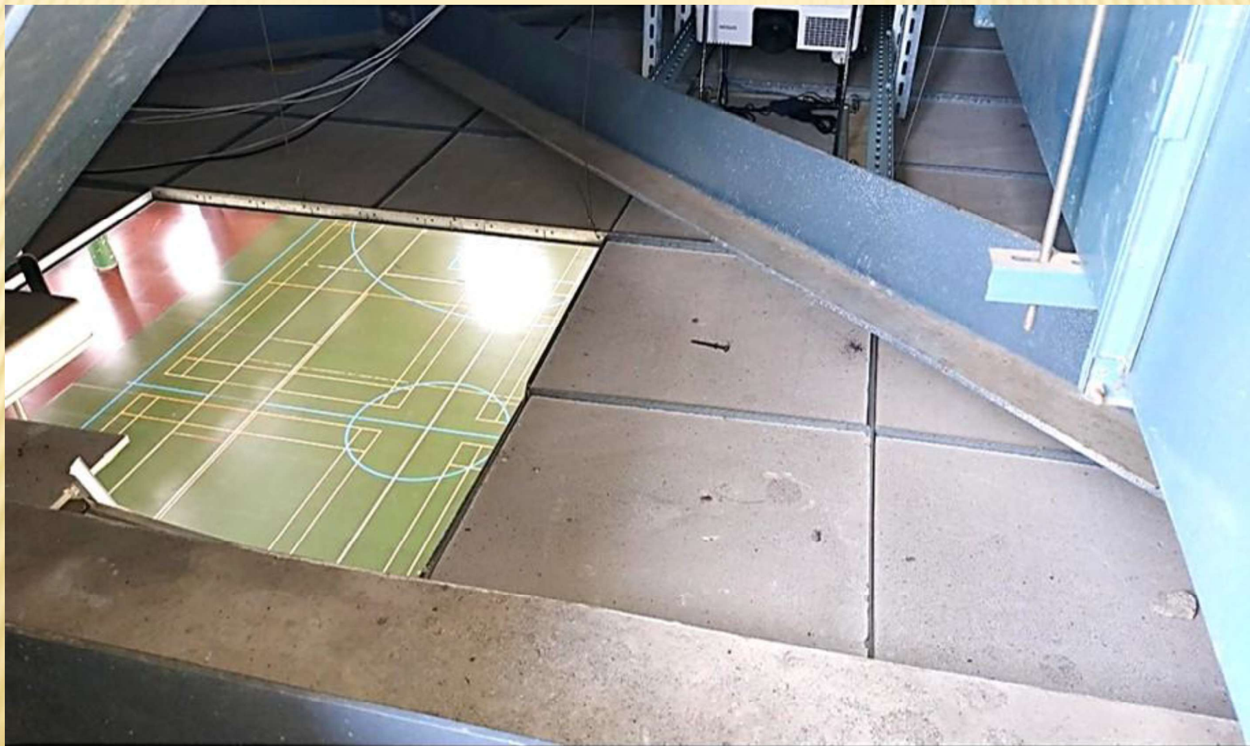
照片 2：罹災者踏穿石膏板形成開口
